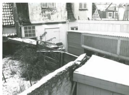
09.1 Sanierungsbedarf im Innenbereich von Block 4
