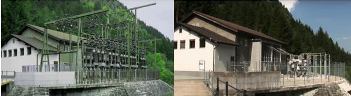
Abbildung 12: Umspannwerk in der Hochspannung für ein Wasserkraftwerk Links: vor Renovierung: Luftisolierte Schaltanlage (AIS). Rechts: nach Renovierung: Hybrid-Schaltanlage (ABB) Quelle: Produktblätter (siehe Anhang)
