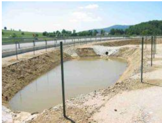
Abbildung II-3: Regenrückhaltebecken einer Straße in Bayern [1]
