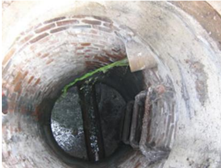
Abbildung III-1: Identifizierung von Falschanschlüssen mit Lebensmittelfarbe im Regenwasserkanal
