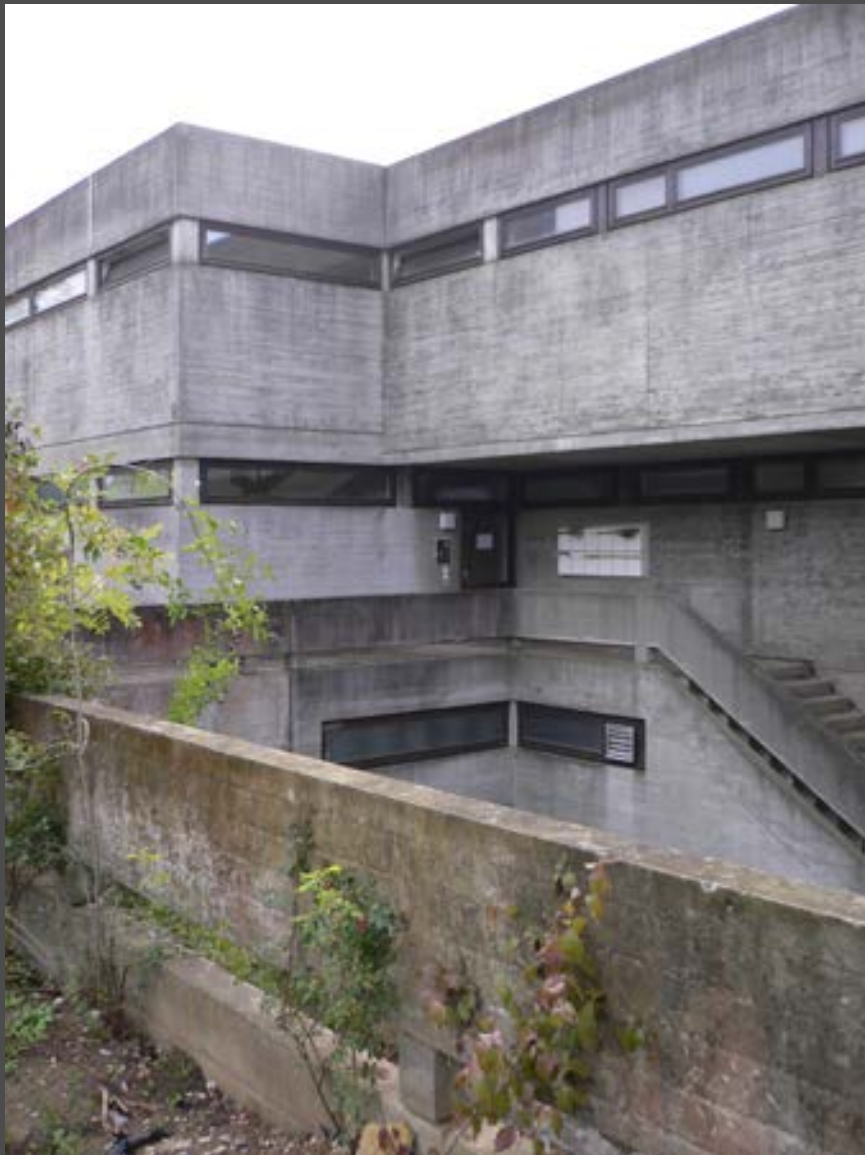
Erhalt von Haptik und Materialität, Gestaltungsabsicht, und reichem historischem Zeugniswert. Tübingen, Waldhäuser Ost, 1968-1974, Überlieferungszustand. Foto: Breitling 2008.
