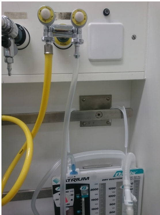
Abb.10 Atrium Oasis direkt am Wandsog angeschlossen mittels Gummischlauch
