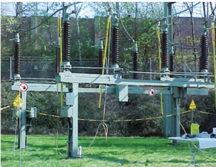
Bild 15: Im Beispiel wird ein abgegrenzter und gekennzeichnete Arbeitsbereich in einer Reihenlängsbauweise errichteten Anlage gezeigt. Durch die Anordnung der eingebauten Erdungseinrichtungen ist der Bezug zur Arbeitsstelle sofort und eindeutig zu erkennen.
