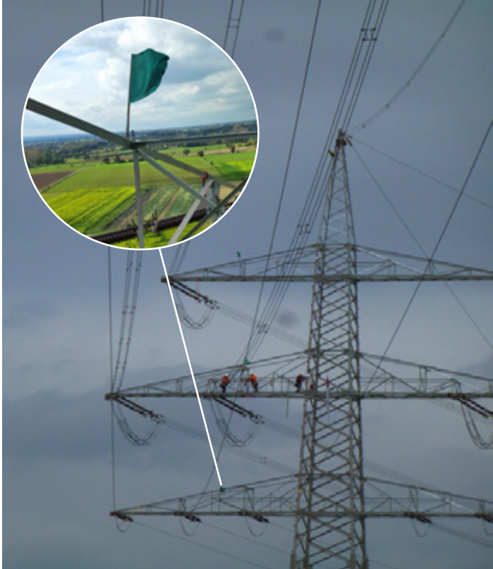
Bild 19: Zeigt einen Hochspannungsmast mit in Betrieb befindlichen und gleichzeitig freigeschalteten Systemen. Die Kennzeichnung der spannungsfreien Systeme mittels grüner Flaggen erfolgt am Zugang in den Traversenbereich.
