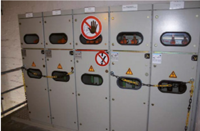
Bild 12: Kennzeichnung des Arbeitsbereiches einer typgeprüften Mittelspannungsnetzstation. Die Kombination aus der Verwendung der gelb-schwarzen Kette sowie des Verbotsszeichens D-P006 erhöht hier die Eindeutigkeit.
