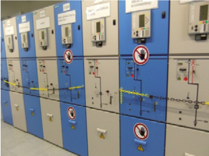
Bild 10: Bei typgeprüften Anlagen in Kompaktbauweise ist es bedingt durch die vermehrten Schottungen in der Anlage und im Schaltfeld möglich, dass auch mehrere Türen/Abdeckungen geöffnet werden können. Hierdurch erhöht sich das Gefährdungspotential.
