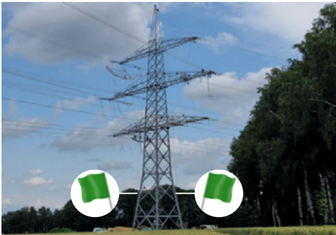
Bild 18: Zeigt einen zum Arbeiten freigegebenen Hochspannungsmast bei dem alle Systeme freigeschaltet sind. Die Kennzeichnung mittels grüner Flaggen erfolgt im Bereich des Masteingangs an den Steiggängen.
