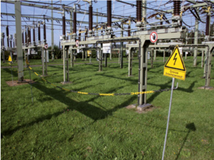
Bild 14: Kennzeichnung eines zum Arbeiten freigegebenen Schaltfeldes mit gelb-schwarzen Ketten und Warnzeichen W012. Hier besteht durch unmittelbar angrenzende unter Spannung stehende Anlagenteile eine zusätzliche Gefährdung. Mittels des Verbotsszeichens D-P006 wird das Anlagenteil zusätzlich gekennzeichnet.
