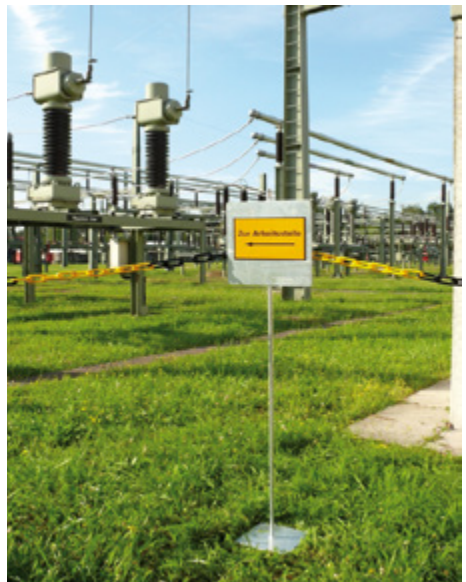
Bild 5: Beispiel zur Einrichtung des Zugangs zum Arbeitsbereich durch Verwendung von gelb-schwarzen Ketten und Zusatzzeichen.
