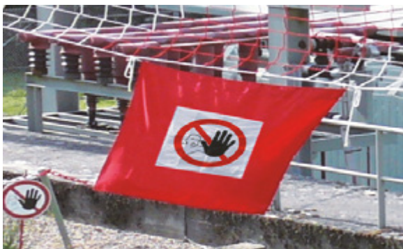
Bild 7: Beispiel zur Kennzeichnung von Gefahrenstellen unter Verwendung von rot-weißen Netzen und Verbotssymbolen beim Kraneinsatz in einer Hochspannungsschaltanlage.
