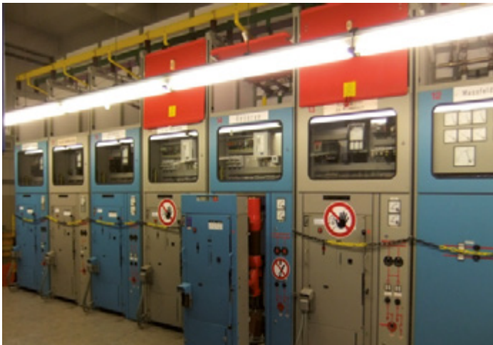
Bild 9: Zeigt eine nach DIN VDE 0101-1 „Starkstromanlagen mit Nennwechselspannung über 1kV, Allgemeine Bestimmungen“ luftisolierte konventionelle nicht typgeprüfte Anlage. Der Arbeitsbereich ist mittels gelb-schwarzer Ketten und Einsatz von isolierenden Schutzplatten gekennzeichnet.
