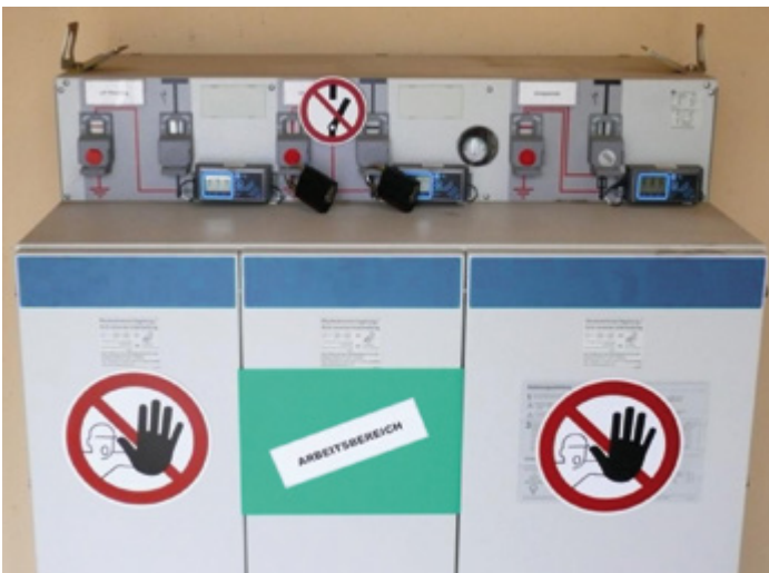
Bild 11: Kennzeichnung bei typgeprüften kompakten Schaltanlagen unter Verwendung einer grünen Farbkennzeichnung für den zum Arbeiten freigegebenen Bereich
