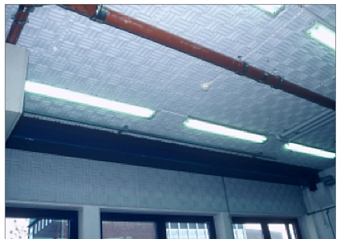
Abb. 6.2 Direkt an Decke und Wände verklebte Absorber aus Melaminharzschaum mit gewellter Oberflächenstruktur.
