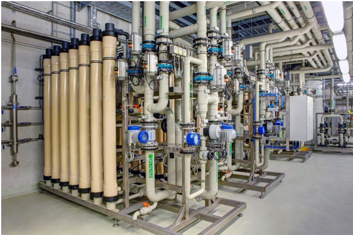
Abbildung 3: Ultrafiltrationsanlage zur Oberflächenwasseraufbereitung (Quelle: OSMO)
