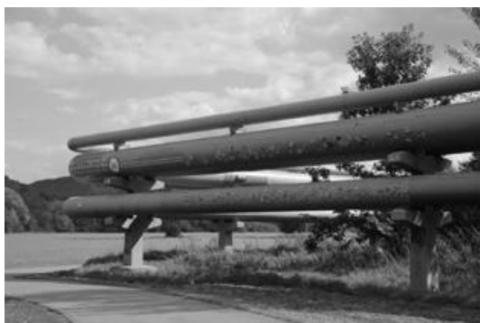
Bild 4.18 Oberirdische Fernwärmeleitungen in Jena (Stadtwerke Energie Jena-Pössneck).
