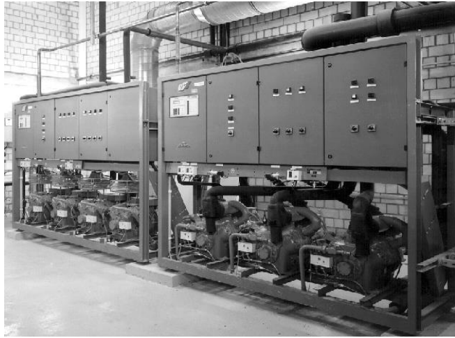
Verbundkälteanlage in einem Supermarkt
