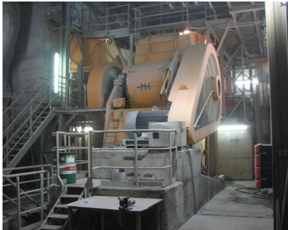
Abbildung 17: Brecher der Vorzerkleinerung unter Tage
