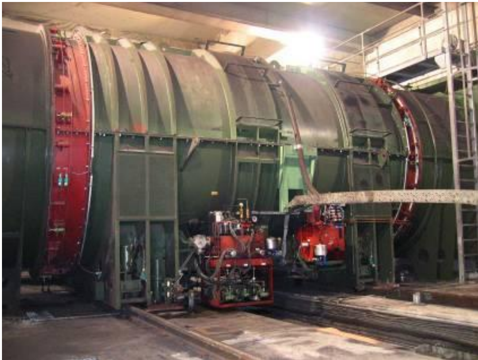
Abbildung 9: Übertägig installierter Hauptgrubenlüfter
