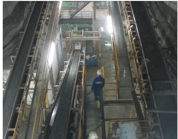
Abbildung 18: Bandanlage für den Transport nach über Tage
