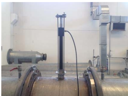
LANZEN-MID DN 700 in Rohrleitung
