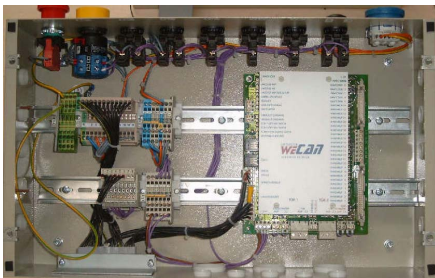
Bild 9 : Fahrkorbrechner im Fahrkorbanschlusskasten
