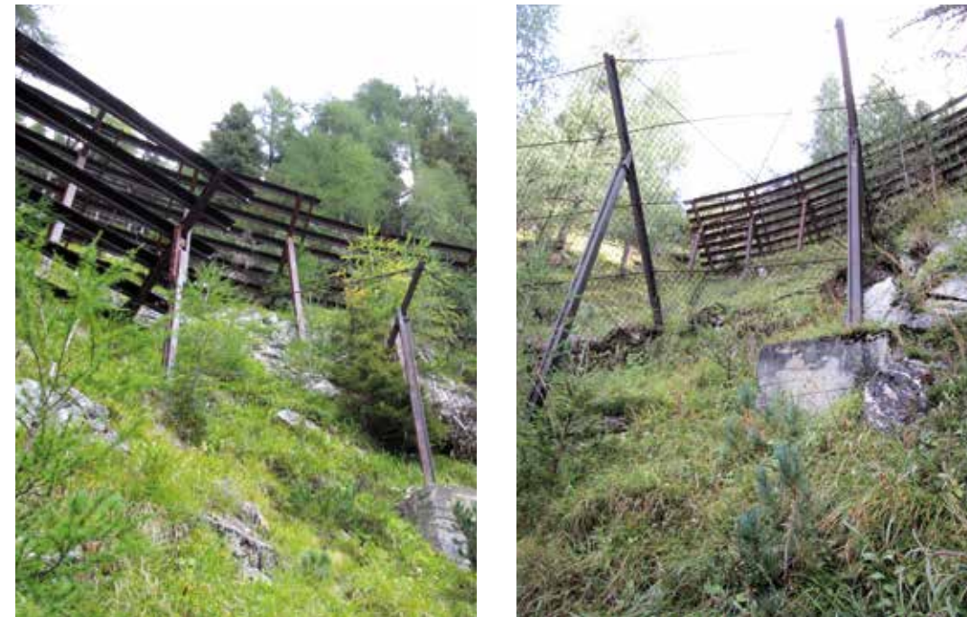
Abb. 3: Neue Stahlschneebrücken zwischen alten Schneenetzen
