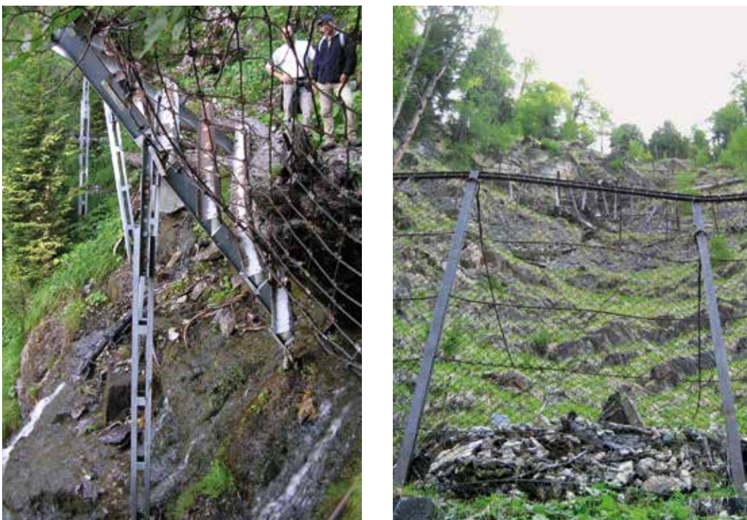
Abb. 2: Beschädigte Stützverbauung infolge Steinschlag (linkes Bild) sowie desolates Schneenet (rechtes Bild)
