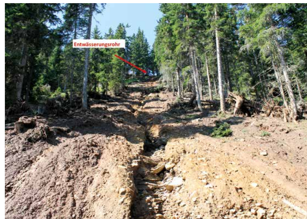
Abb. 4: Unterhalb der Forststraße bildete sich eine flachgründige Rutschung aus, die beim Eintrag in das Gerinne eine Tiefenerosion auslöste
