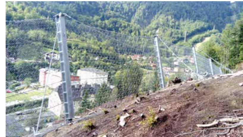
Abb. 3: Bannwald Brenntekogl, Steinschlagschutzverbauung Aufnahmekapazität 3000 kJ, Schutz des Ortsteiles Kohlstatt, Marktgemeinde Ebensee
