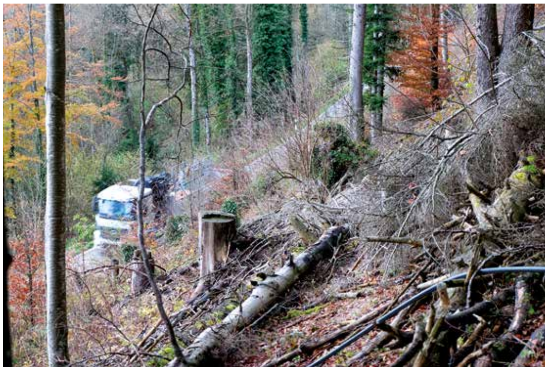
Abb. 3: Steinschlagschutzwald nach einem Eingriff oberhalb einer Straße mit liegendem Holz zur Erhöhung der Bodenrauigkeit (Bild: B. Lange)
