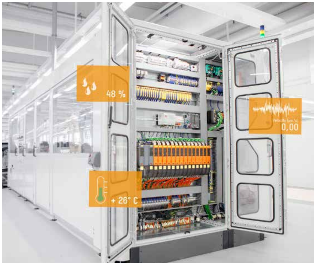
Ein überwachter Schaltschrank hilft dabei, Fehlfunktionen zu vermeiden.
