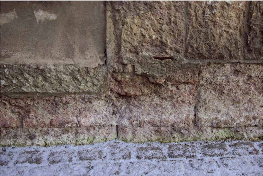
Abb. 6 Verwitterungserscheinungen an Hilbersdorfer Tuff im Sockel eines gründerzeitlichen Gebäudes.
