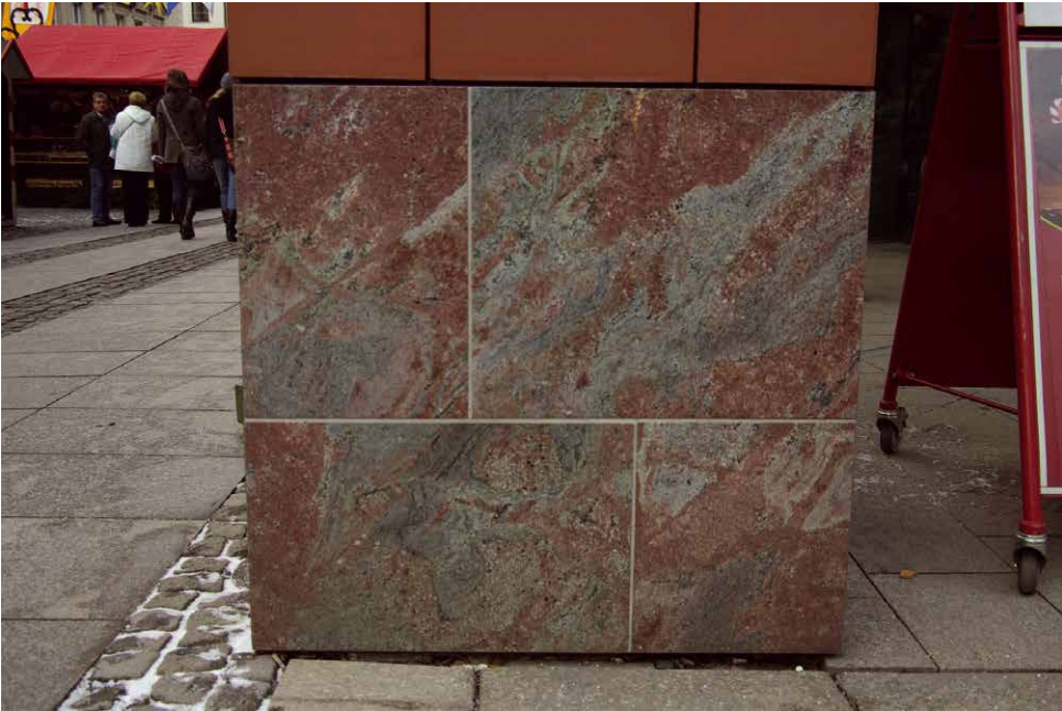
Abb. 18 Einsatz eines metamorphen Gesteins (Migmatit Verde Tropical aus Brasilien) in der Sockelzone der Rathauspassagen in der Inneren Klosterstraße (2003 eröffnet).
