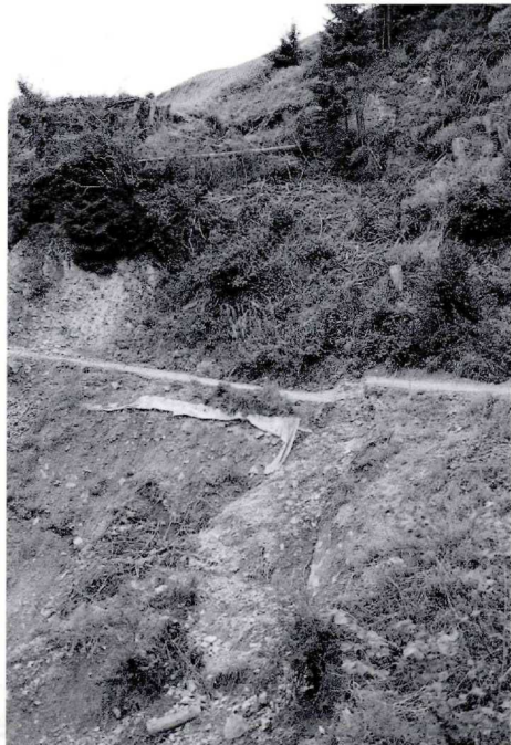
Abb. 5. Alte Hofzufahrt zum WARTSCHER (nach dem ersten Ereignis 1997), die schon vor den letzten drei Muren im Bereich des WARTSCHENBACHES Hangnarisse aufwies.
