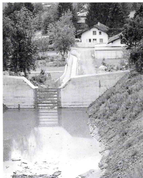
Abb. 11. Geschiebedosiersperre oberhalb der WARTSCHEN-SIEDLUNG und WARTSCHEN-BACH-Verbauung am unteren Schwemmkegel, Verbaumaßnahmen 1986.
