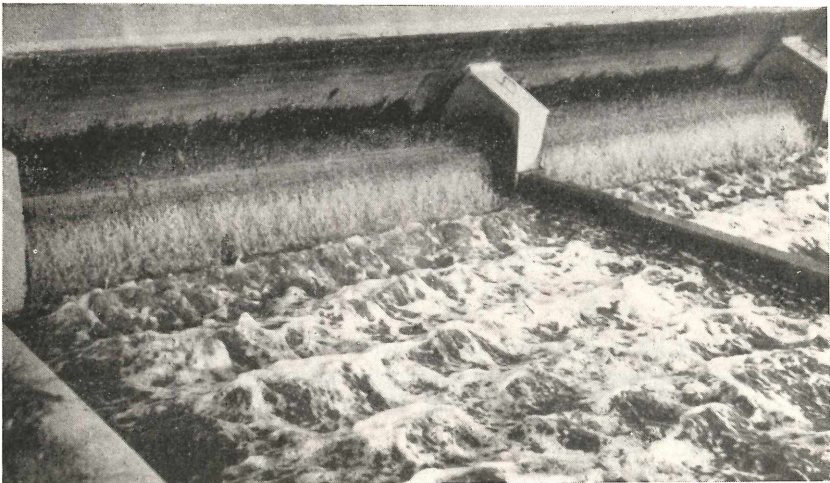
Abb. 19. Belebtschlammanlage mit rotierenden Bürsten
