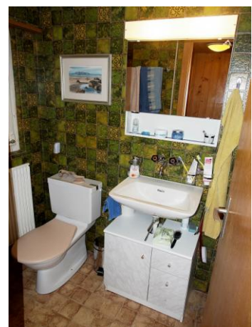
Dusche, WC, Lav. OG
