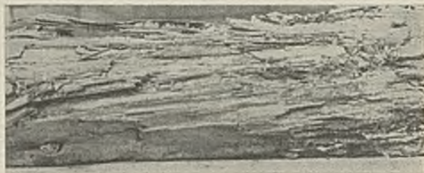
Abb. 1. Zerstörung von Holz durch Salzwasser.
