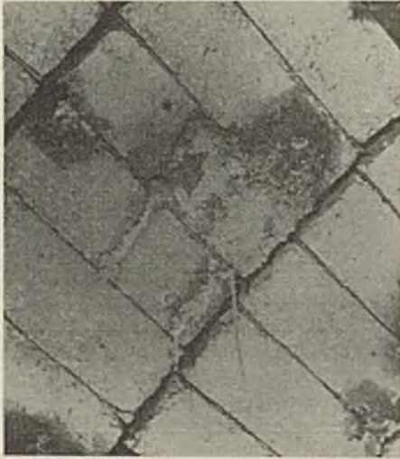
Abb. 7. Korrosionsangriff an Betonformsteinausbau.
