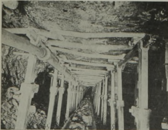
Abb. 3. Bruchfreies Hangendes zwischen Kohlenstoß und Wanderkasten.
