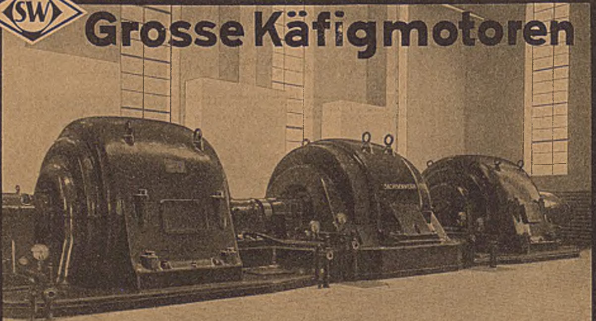
6000-kW-Käfigmotor (in der Mitte) gekuppelt mit zwei Drehstromgeneratoren. Das Anlassen des Aggregates erfolgt mit Hilfe eines zum Hauptmotor in Serie geschalteten Anwurfmotors.
