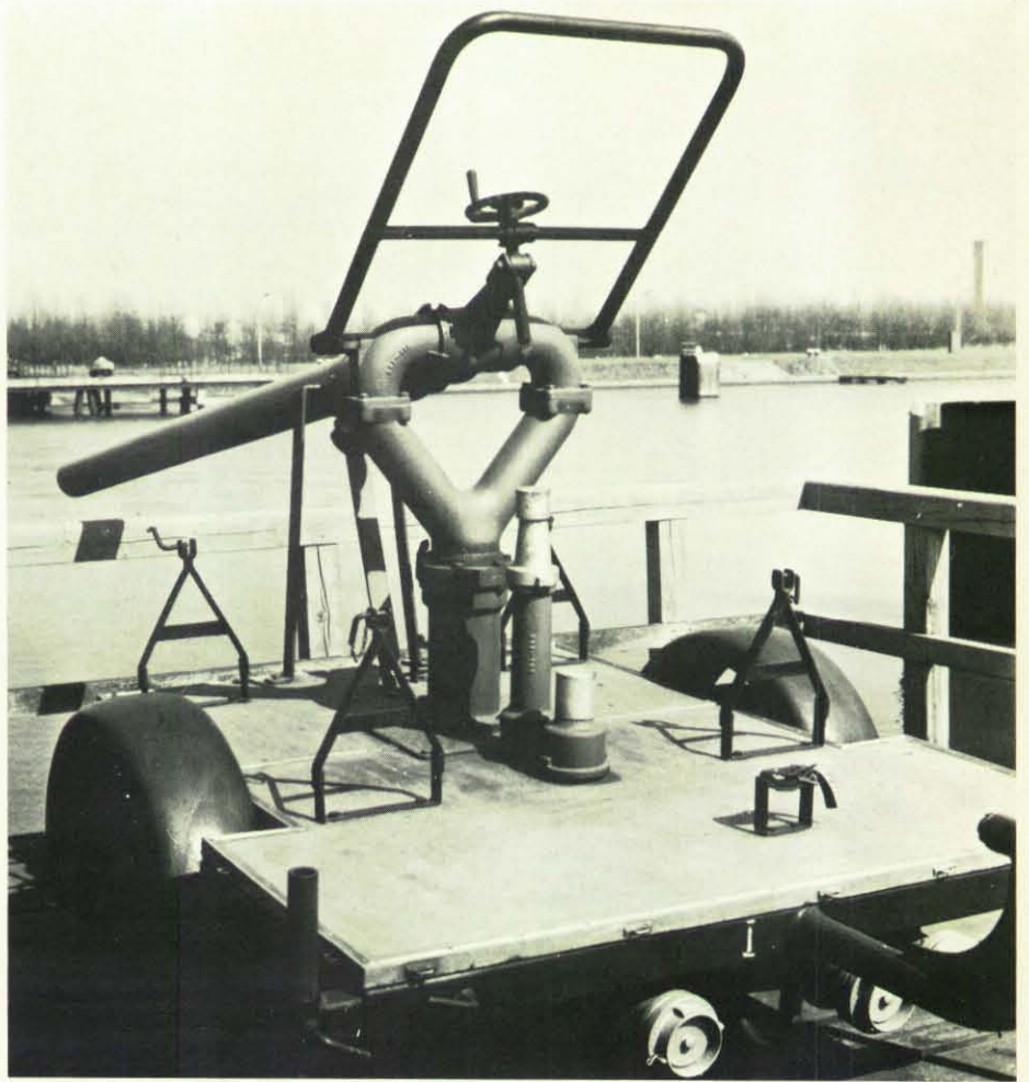
Bewegliche Löschkanonen ergänzen die stationären Feuerlöschanlagen.
