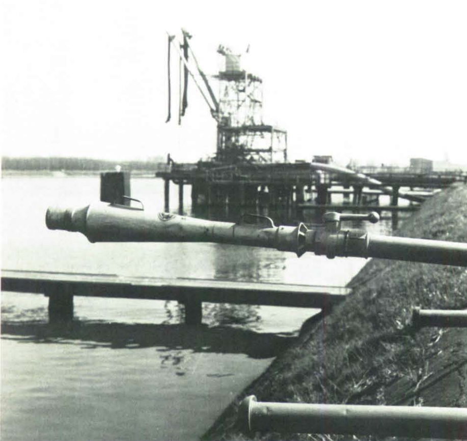
Zur schnellen Beschäumung der Wasseroberfläche bei einem Brand sind die Schaumlöschrohre in ständig geöffnetem Zustand auf das Hafenbecken gerichtet.
