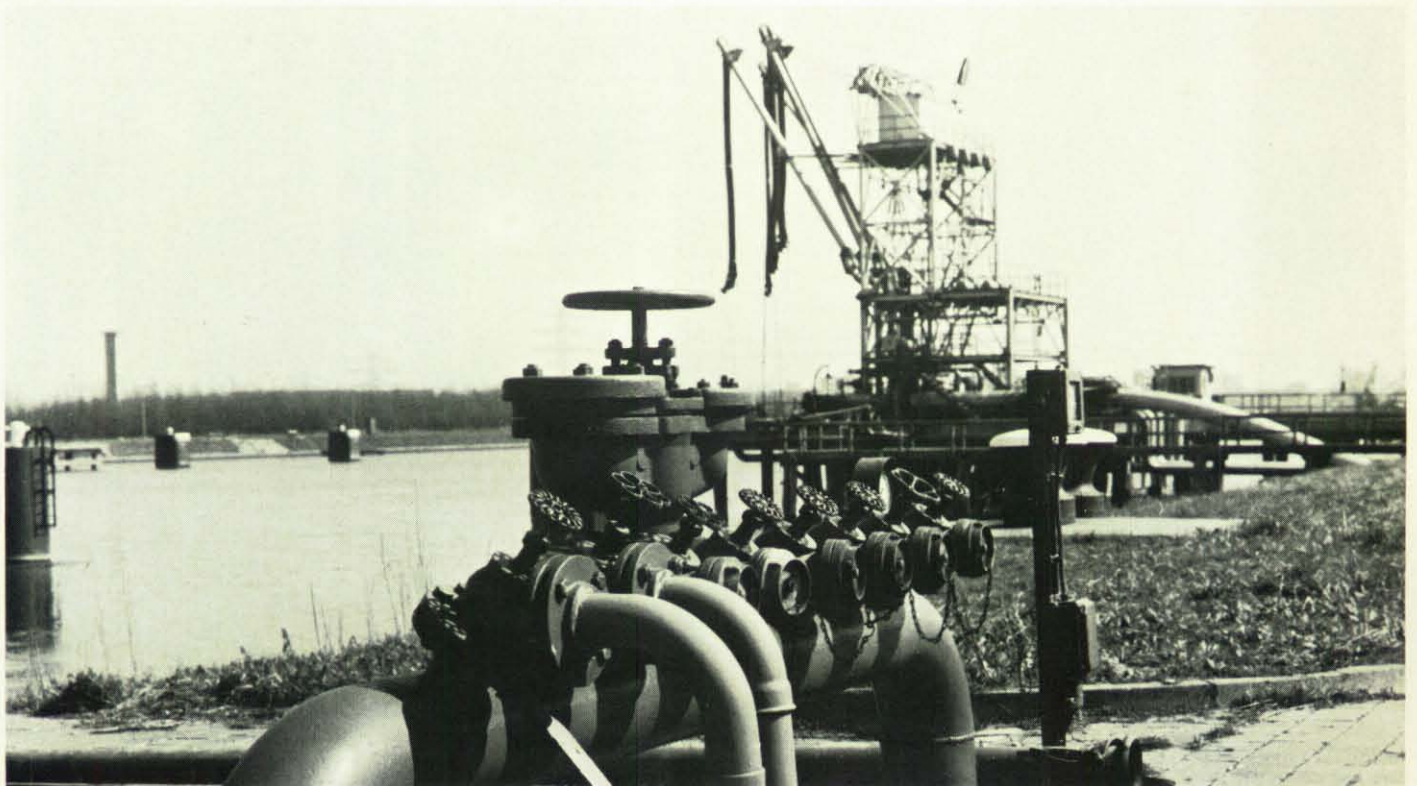
Rund um das Hafenbecken im Abstand von jeweils 150 m befinden sich die Druckstutzenbatterien, die vom Pumpenhaus gespeist werden.
