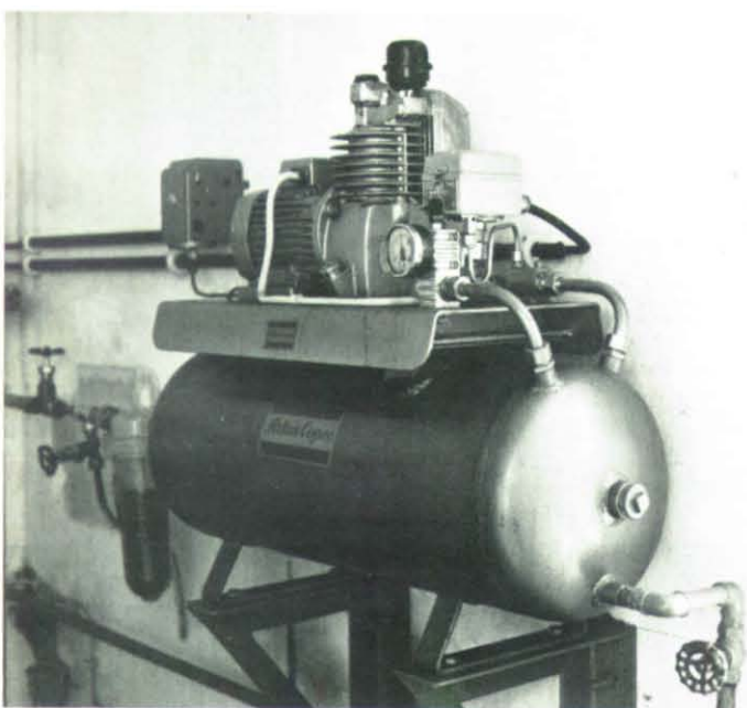
Dieser kleine Kompressor ist immer in Betrieb. Er liefert Steuerluft und hält die pneumatischen Ventile ständig funktionsbereit.
