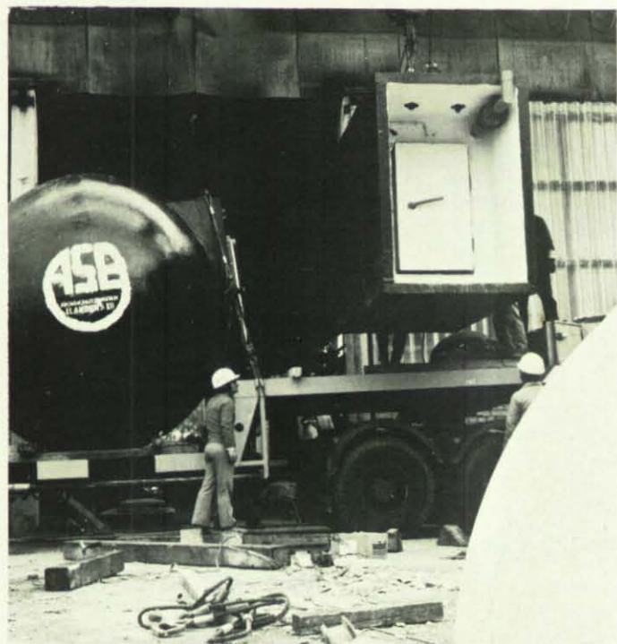
Kugelschutzraum und zugehöriges Verbindungsstück mit Schleuse passen zusammen auf einen Tieflader.
