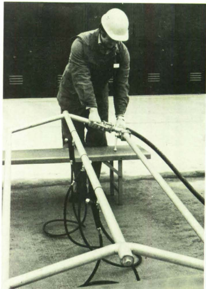
Der Duschrahmen mit Handbrausen wird auf seine Funktionsfähigkeit überprüft.
