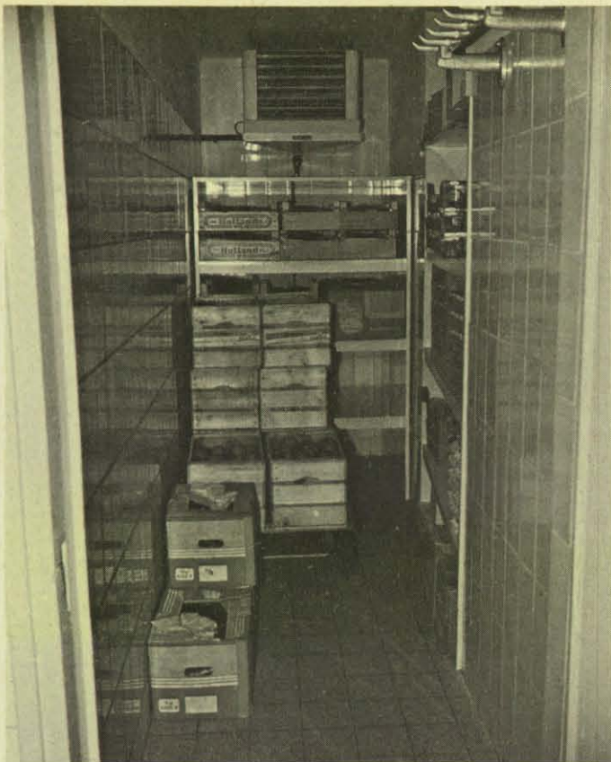
Großzügige Kühlräume für Fleisch und Gemüse stehen zur Verfügung.
