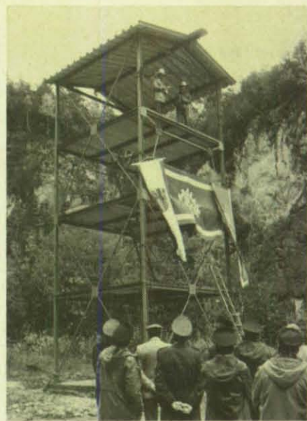
Baumeister Andreas Pohl hält von der obersten Plattform des neuen Turms seinen Richtspruch. (Foto: Zanus)
