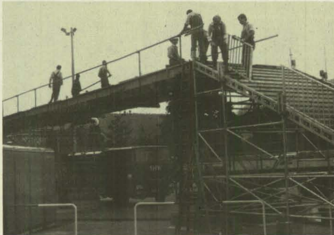
Die THW-Helfer montieren am Steg und den Treppen die Handläufe. (Foto: Steffan)
