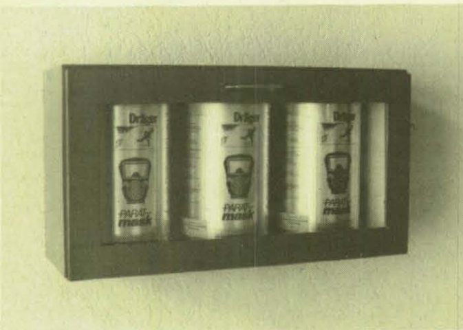
Je drei Filtergeräte mit Haube zur Selbstret- tung auf allen Fluren geben Sicherheit bei einem Brand.
