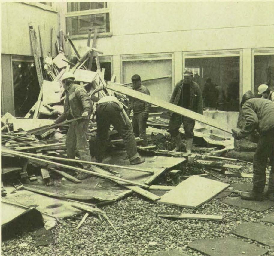
Das Dach des Krankenhauses in Bietigheim (Baden-Württemberg) hielt dem Sturm nicht stand.
