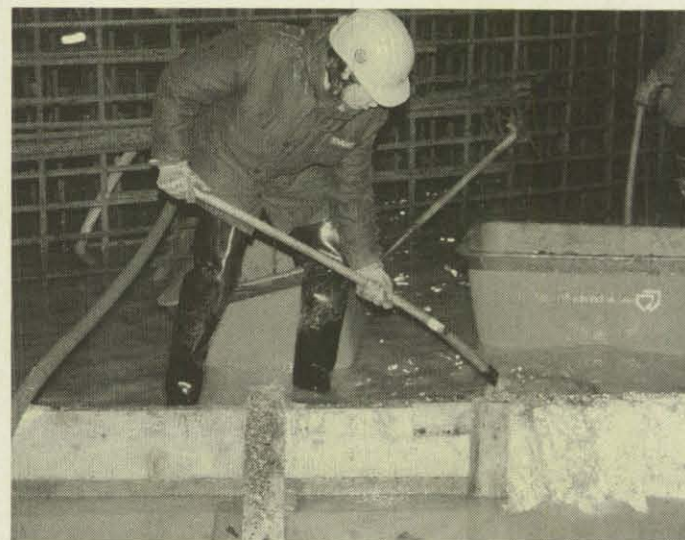
Bei null Grad Temperatur keine angenehme Arbeit: Das Wegschwemmen des Betons. (Foto: Graser)
