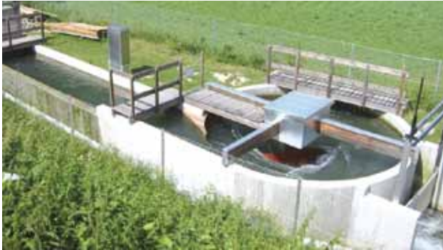
GWWK-Anlage an der Suhre in Schöffland
