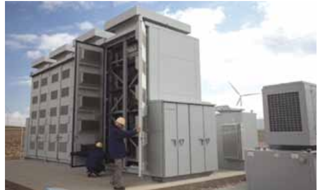
Eine Schwefel-Natrium-Batterie soll die Schwankungen in einer Windfarm in Minnesota abfedern. Quelle: Xcel Energy
