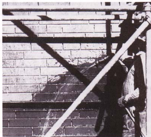
Abb. 3: 1. Angriffsfläche: Offene oder wieder ausgekratzte Fugen ermöglichen beim Vornässen dem Wasser, ins Innere des Mauerwerks zu gelangen.
