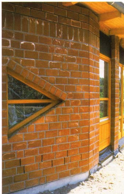
Abb. 5: Typische Ausblühungen auf frisch erstelltem Verblendmauerwerk nach Reaktion zwischen Salzsäure und Mörtel-Bindemittel.
