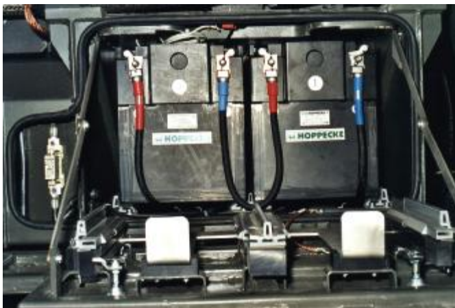
Batterie mit Batteriesicherung
