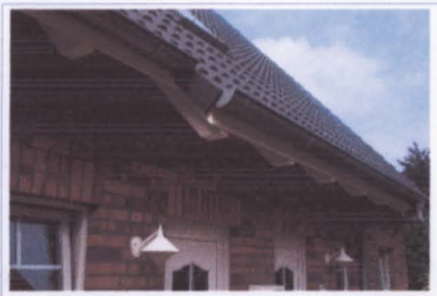
Eine Reihe Dachpfannen im Eingangsbereich heruntergezogen.
