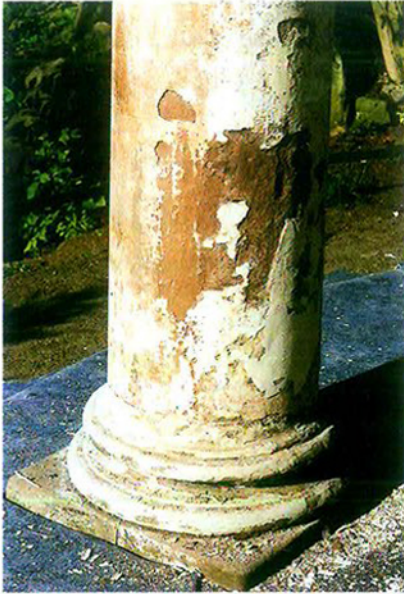
Abb. 3: Steinschäden an einem Säulenfuß
