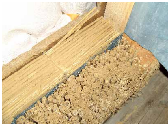
Die Dachfensterlaibung mit dem handbehauenen alten Sparren, die zwei Dämmschichten, der dazwischenliegenden Winddichtung und dem Unterdach aus einer Holzfaserverplatte
