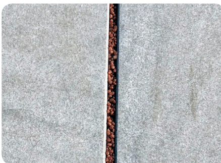
Vollständig gefüllte Fugen
