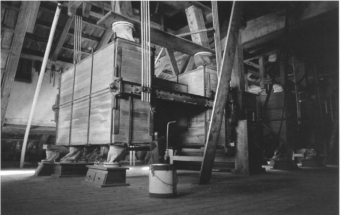
Plansichter der Dürmentinger Mühlenbaufirma Brobeil in der stillgelegten Mittelmühle Kehrle am Aufhofer Mühlbach, Gemeinde Schemmerhofen (September 2003).
