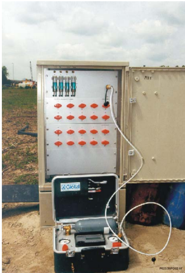
Abb.: Messzentrale mit Luftmengenregler ALR
