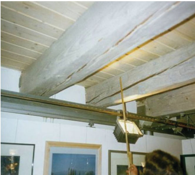
Bild 17. Klaffende Schwindrisse in einem alten, nun beheizten Gebäude
