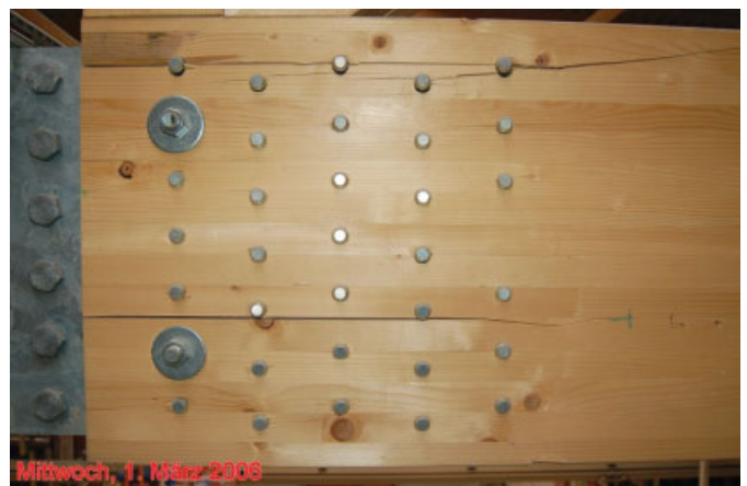
Bild 18. Tragfähigkeitsmindernde Rissbildung im Bereich von Stabdübelverbindungen eines Zugstoßes (Stabkraft:
