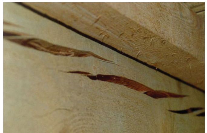
Bild 16. Klaffende Schwindrisse in einem Fachwerkobergurt Fig. 16. Large breaks in a compression member of a lattice girder
