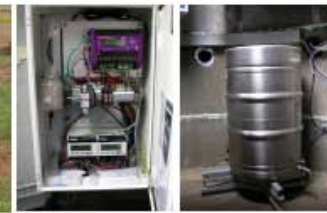
Datensammler, Steuerung, Sickerwasserwaage
