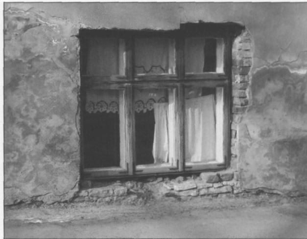
FASSADENSCHÄDEN an einem Gebäude des ehemaligen jüdischen Viertels.
