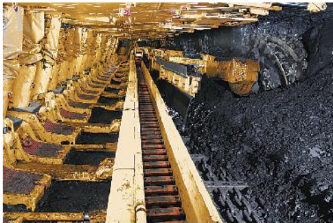
CAT Strebausrüstung mit EL2000
