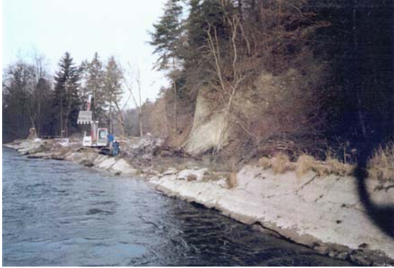
Abb. 5-18 Altes Betonleitwerk an der Aare Winter 1998/99 [Foto: Tiefbauamt Bern]
