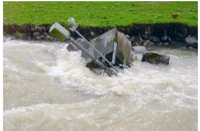
Abb. 2.31 > Die starke Quellschüttung führte im Zuge der Starkniederschläge vom August 2005 zu entsprechenden Schäden an der Messstelle.
