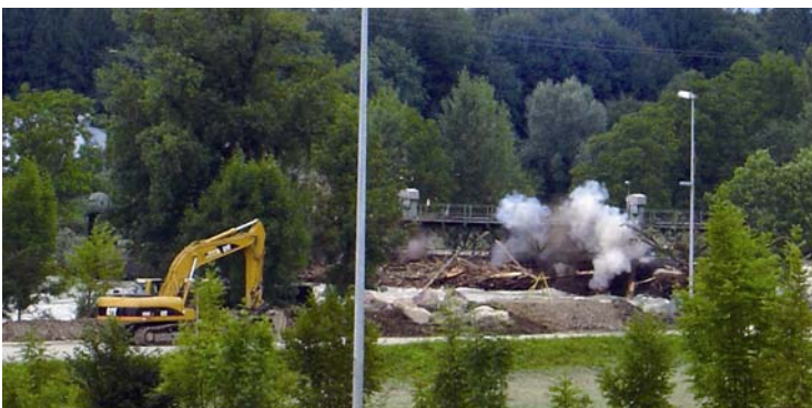
Abb. 5.12 > Sprengung der Verklausung beim Wehr Perlen, Kt. LU.
