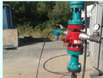
Fertig aufgebaute Pumpe
