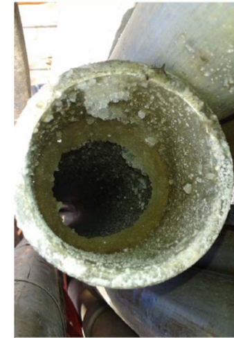
Kristallisation im Steigrohr v.a. im Muffenbereich
