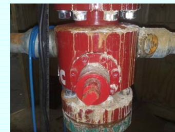
Salzausblühungen an Pumpe
