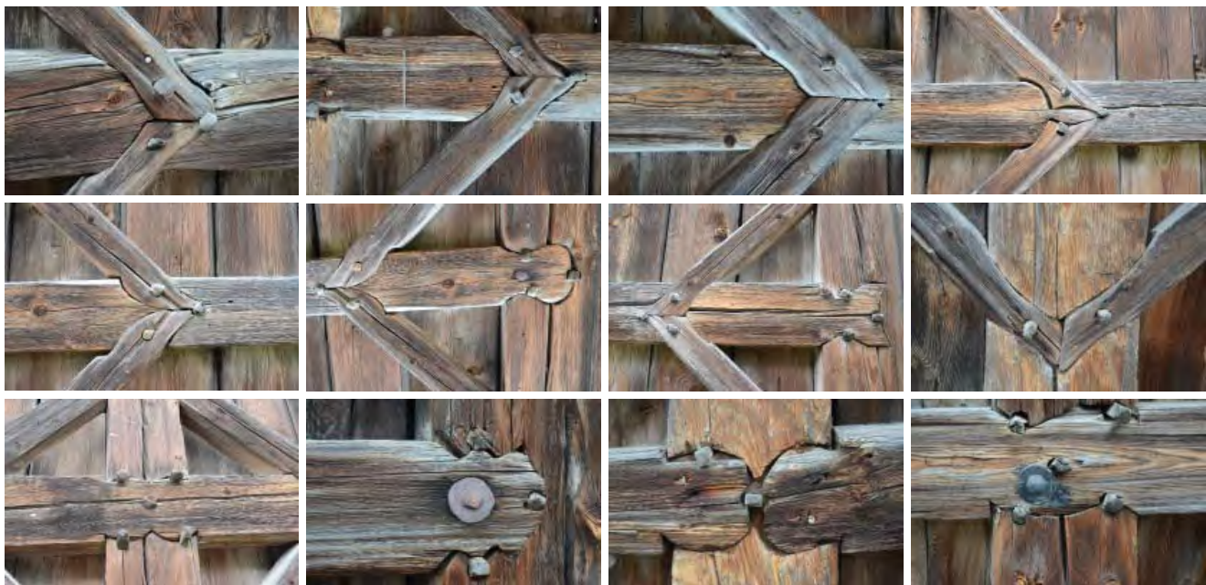
Abb. 50, Verblattungen an der Bundwerkwand des Stadels in Hochburg-Ach
