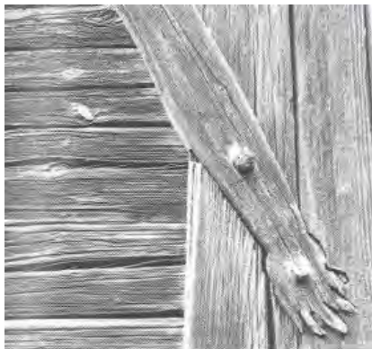
Abb. 48, Kopfband in Form einer Hand, mit der Säule verblattet an einem Stadel in Grundlhub / Vilsbiburg (Lkrs. Landshut, 1854)
