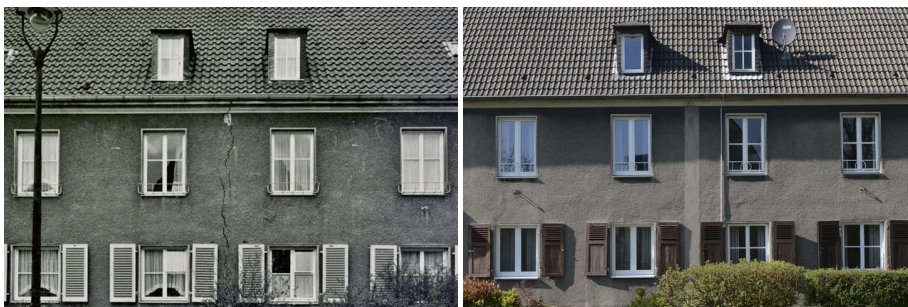
Abbildung 3.8: GLA · BR · 01 Bergschäden am Wohnhaus einer ehemaligen Werksiedlung. Vermutlich wurde das große Doppelhaus privatisiert, denn es wurden in beiden Haushälften unterschiedliche neue Fenster eingebaut. Das Äußere des Hauses ist im Wesentlichen unverändert, die Bergschaden-Risse wurden jedoch beseitigt. (Quelle: Scharioth und Schräpler 2017)
