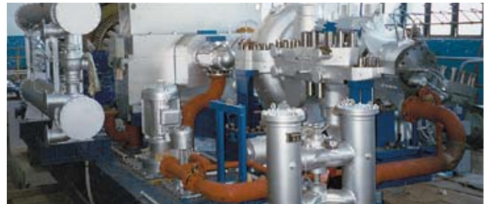
České Budějovice, Tschechien: 29-MW-Gegendruckturbine für ein Fernheizkraftwerk
