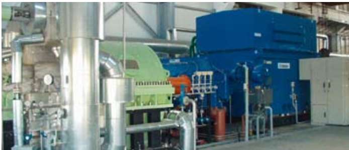
Mielec, Polen: 21-MW-Kondensationsturbine mit Entnahme in einer kohlebefeierten KWK-Anlage des polnischen Energieversorgers Elektrociepłownia Mielec
