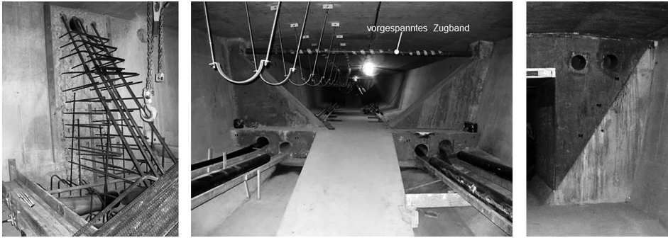
Bild 75. Einbau nachträglicher Umlenkstellen bei Kastenquerschnitten, im Feldbereich (links und Mitte; mit obenliegendem Querschnitt), Querschnittsergänzung an vorhandenem Stützquerträger (rechts)
