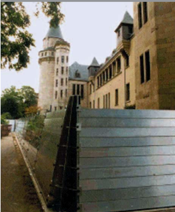
Mobiler Hochwasserschutz mit Dammbalken
