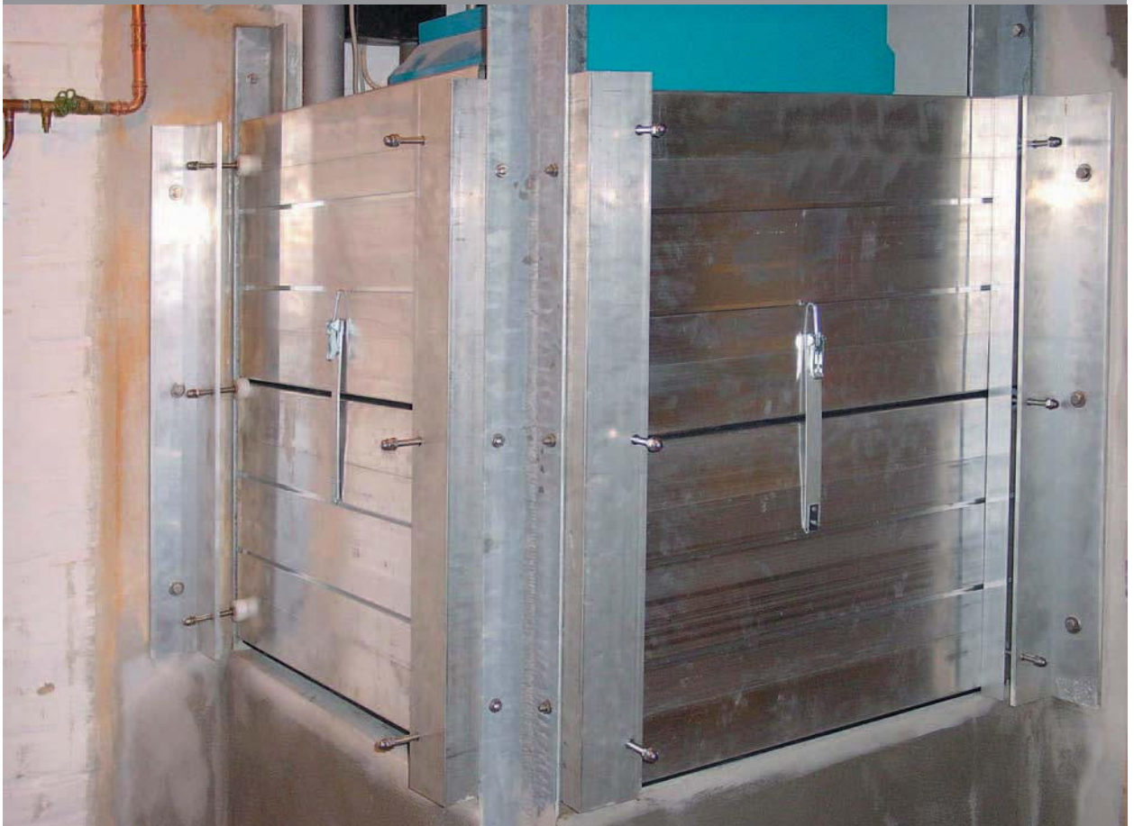
Sicherung eines Heizungs Brenners
